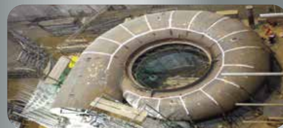
Central Hidroeléctrica - MAZAR
