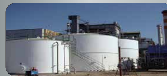
Central Térmica Guemes - PAMPA ENERGIA
